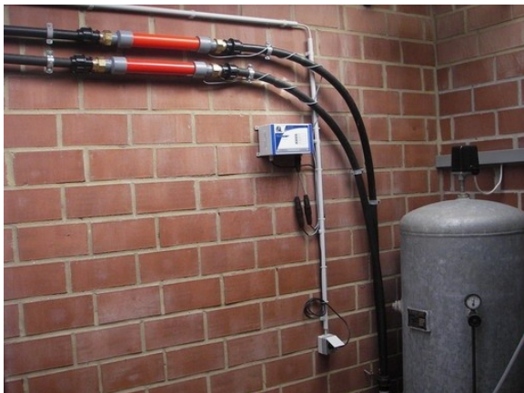
Installation in einem Viehzuchtbetrieb in Cloppenburg (Deutschland, März 2007)
